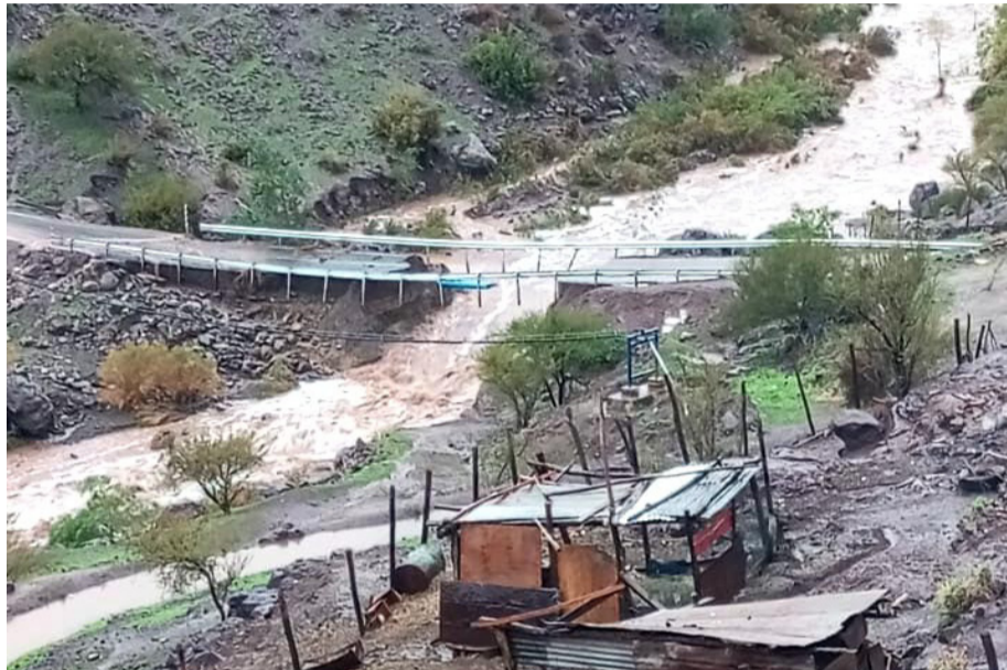
En la Ruta D-783, que conecta el Valle Hermoso con Matancilla, en Combarbalá, el tránsito se encuentra suspendido por la destrucción del puente sobre río Pama.
